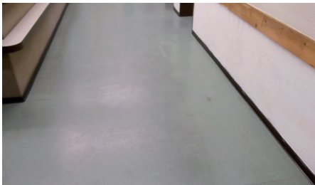
Bild 1: Ausgangszustand: schmutziger, matter Belag
