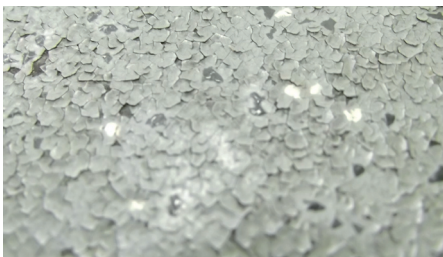
Bild 2: Nahaufnahme geschädigter Belag
